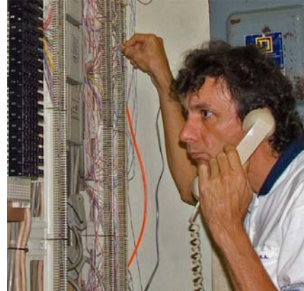
Hay veces unas de las muchas líneas telefónicas internas necesitan reparación también.
